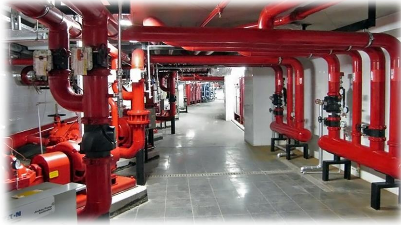
YANGIN POMPA ve KOLLEKTÖRLERİ ANA MEKANİK ODA
